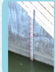
堀内水門水位表示板
